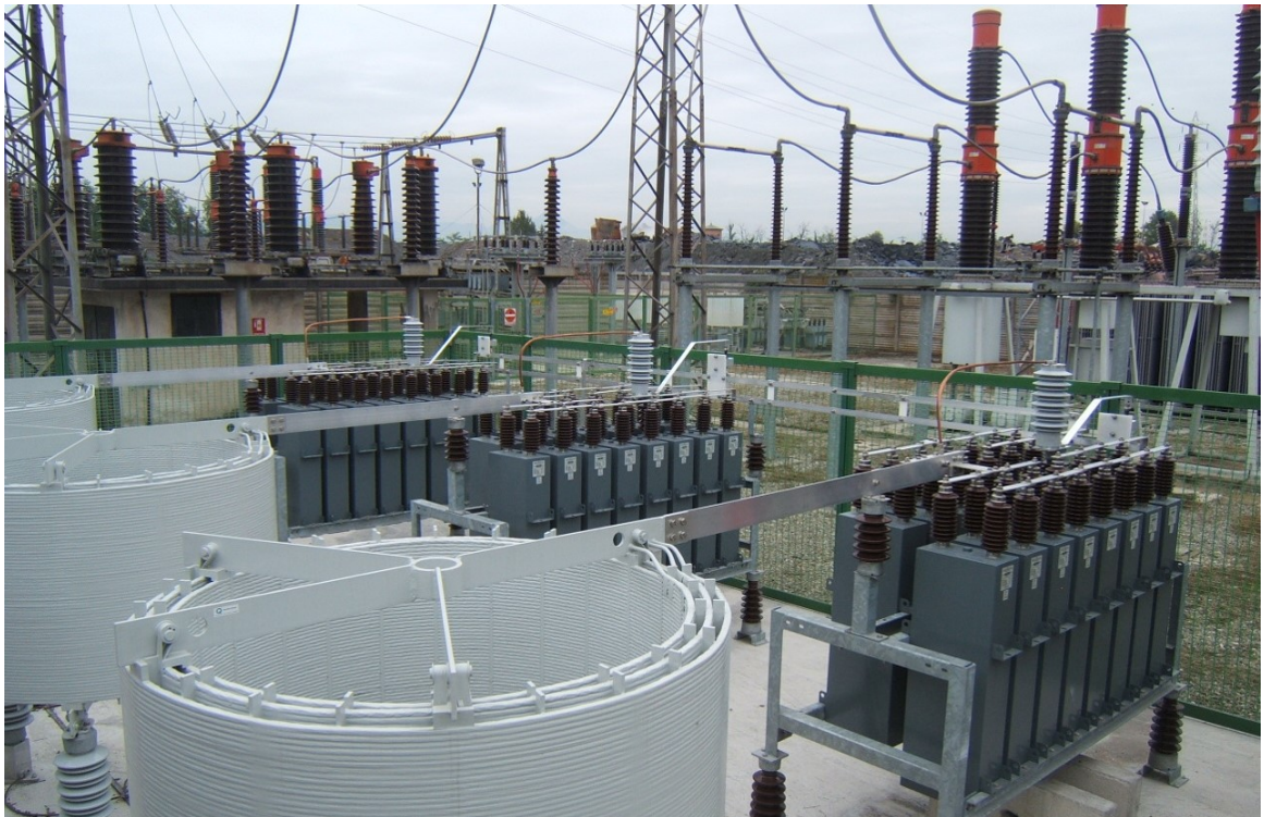
FIGURE 8.4 – Batterie de condensateurs dans un réseau de distribution de l'énergie électrique
